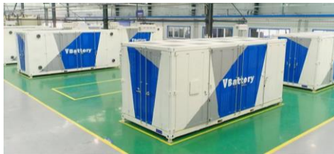
100MW/400MWh全钒液流电池储能电站
