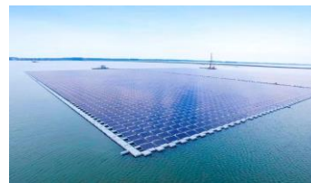
水面漂浮式光伏电站
