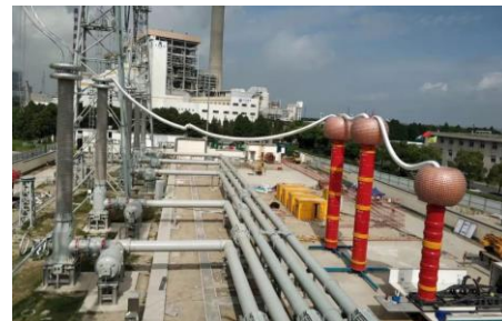
1100\text{kV} 特高压GIL装备
