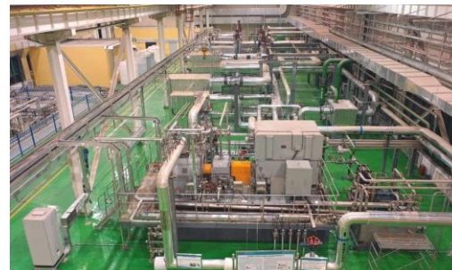
5MW超临界二氧化碳循环发电机组 5MW Supercritical CO 2 Cycle Generator
